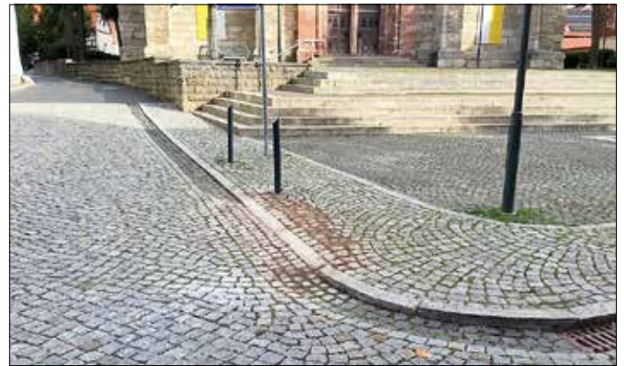
Zahlreiche Bordsteinabsenkungen wurden im gesamten Stadtgebiet durch den Bauhof ausgeführt. Hier ein Beispiel im Sanierungsgebiet der Ortschaft Dingelstädt vor der Kirche
