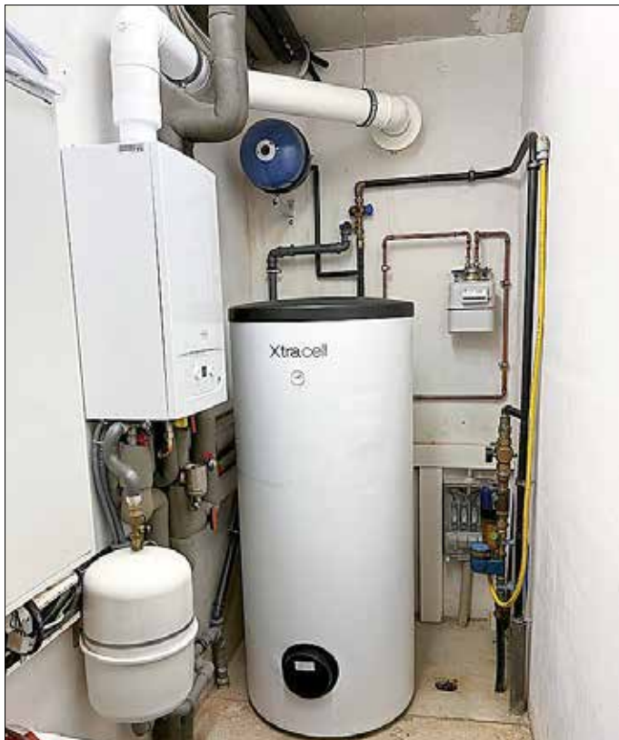
Neue Heizungsanlage im Sporthaus
