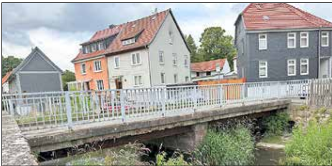
Marode Brücke über die Unstrut in der Brückenstraße
